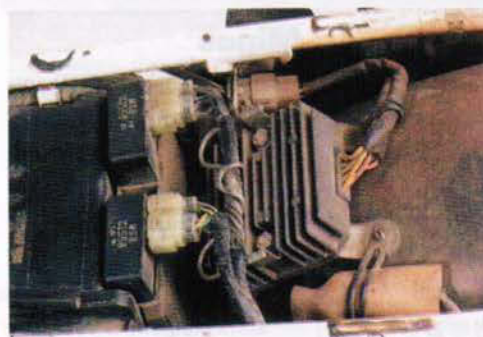
Problemfall der RD03: die beiden zu dicht unter der Sitzbank montierten CDI-Einheiten (links im Bild).
